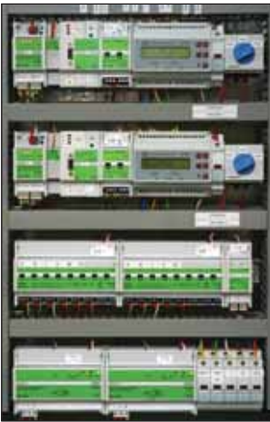
Bild 3. KNX Komponenten im Messraum Dachgeschoss.
