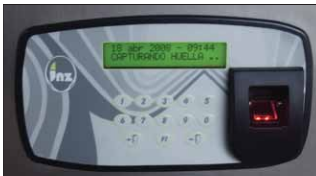
Bild 4. Dank Schnittstelle der Zutrittskontrolle (Fingerprint) zur KNX Anlage ist die bedarfsgerechte Steuerung und Regelung aller Anlagen möglich
